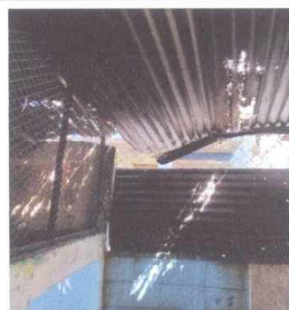
Foto 2: Láminas rotas en el establecimiento. Provocando suficiente ingreso de aguas en el interior de la escuela en tiempo de invierno.
