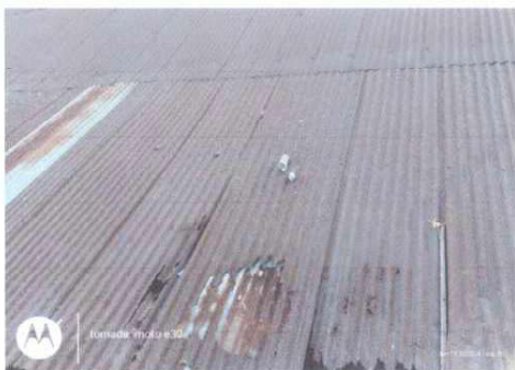
Foto7: Laminas oxidadas y picadas.
