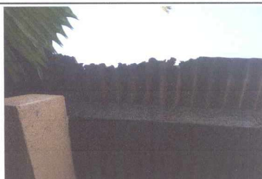
Foto 4: Láminas picadas, oxidadas, con pedazos cayéndose poco a poco.
