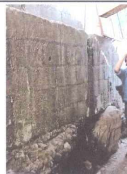
Foto10: Muro de contención con agujero, mucha humedad y cemento sobre tierra por erosión.
