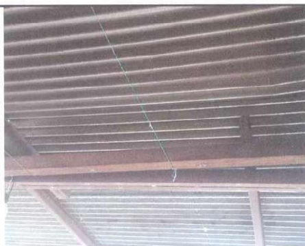
Foto 3: Láminas rajadas y oxidadas
