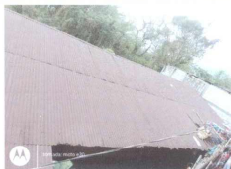
Foto 8: Laminas oxidadas y picadas.
