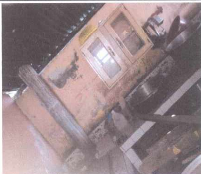
Foto 1: Paredes de cocina con hongos de humedad, provocando contaminación en el espacio.
