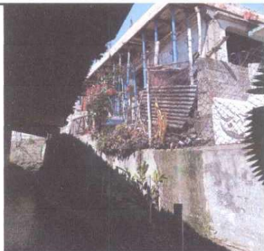
Foto 1: Muro de contención de 24 mts de largo tipo L, en mal estado, a punto de desplomarse, por construcciones pesadas en el lado norte de la Escuela.
