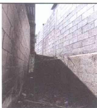
Foto 5: Muro de contención sin refuerzo, ni repello.
