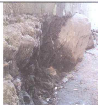
Foto 2: Cimiento de muro de contención a la interperie, con mas de 18 años de haberse construido.
