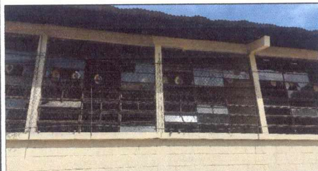
Foto 3: Balcones de la escuela en mal estado en el lado donde se ubica el campo de fútbol comunitario.
