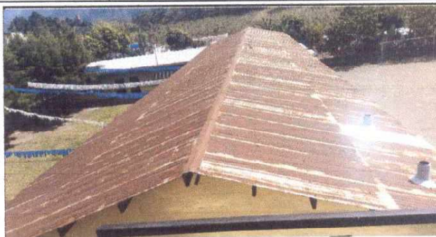
Foto 2: Techo de lámina del centro educativo en mal estado.
