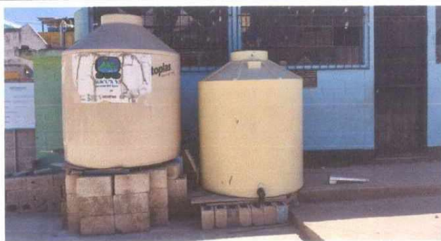
Foto 3: Base de Deposito de agua en mal estado
