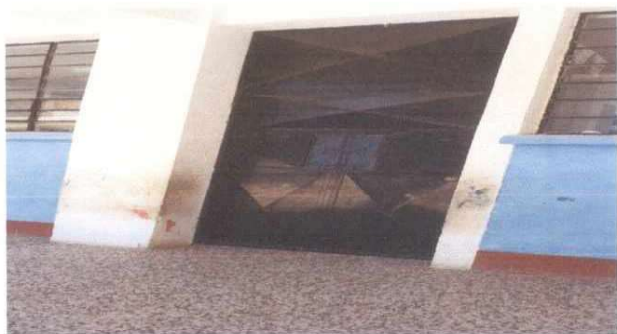
Foto 1: Pintura en exterior manchadas
