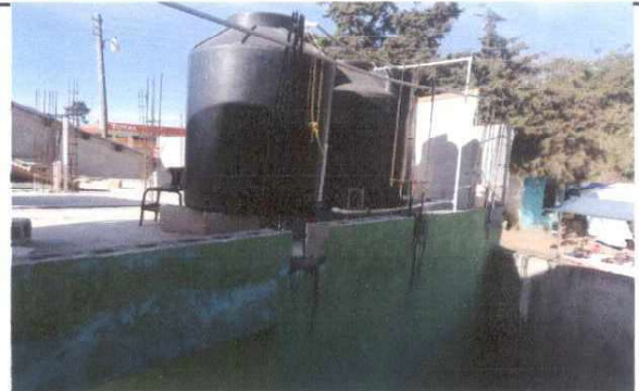
Foto 4: Se sustituirán los depósitos de agua, los actuales están en mal estado y por la cantidad de estudiantes y la escases de agua en la comunidad, se necesitan mas grandes.
