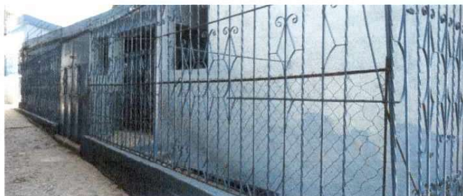
Barandas que se sustituirán por una estructura nueva
