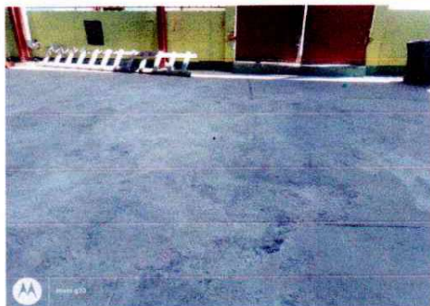
Foto 1: Loza de patio en mal estado, necesita sustitución.
