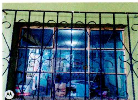
Foto 4: Balcones en mal estado, necesita mantenimiento.
