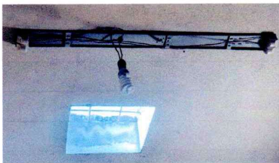
Foto 3: Sistema eléctrico en mal estado, necesita reparación
