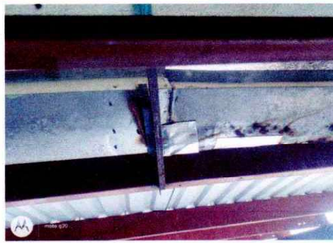
Foto 2: Canales en mal estado, necesitan sustitución
