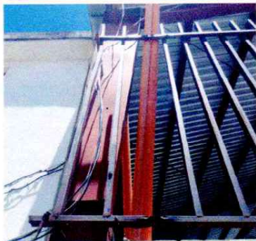
Foto 1: Baranda en mal estado, necesita mantenimiento.
