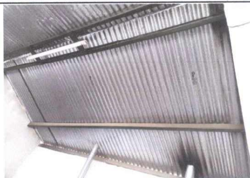
Foto 2: Es necesario el cambio de techo de la cocina por el deterioro y colocarle cielo falso para evitar que caiga cereno sobre los utensilios de cocina y evitar que entre polvo.
