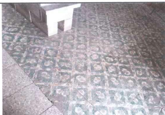
Foto 4: Se sustituir el piso porque ya se encuentra muy deteriorado, además tiene dos estilos de piso
