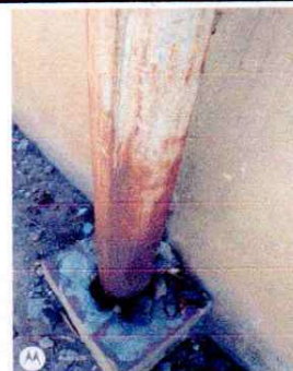
Foto 2: Chimenea en mal estado, necesita sustitución
