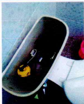
Foto 3: Tanque de sanitario en mal estado, necesita sustitución de accesorios.
