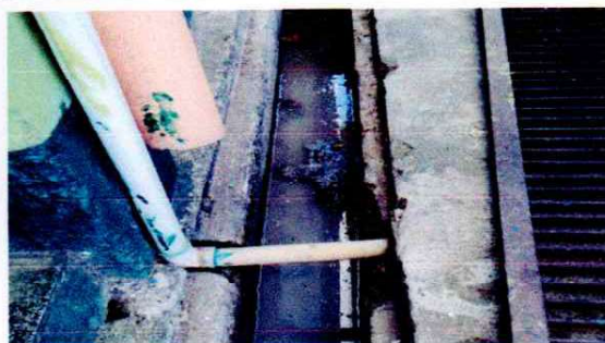
Foto 4: Cuneta de agua pluvial sin desnivel, necesita reparación
