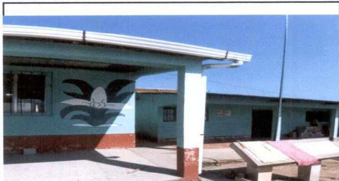
1. Estructura de techo en mal estado.
