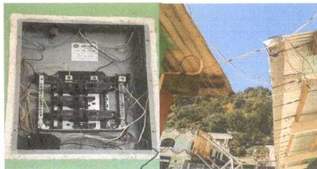
Foto 2. Se necesita reparacion del sistema eléctrico.
