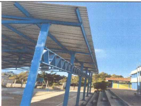
Foto 2: Canales y Bajada de Agua pluvial de ambos lados del Patio Cívico y cancha deportiva para evitar acumulación de agua dentro de la instalación.
