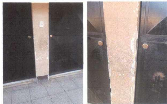
Foto 2: En la fotografía se puede observar la falta de mantenimiento y pintura de las puertas. Es por eso que se pintará con pintura anticorrosiva.
