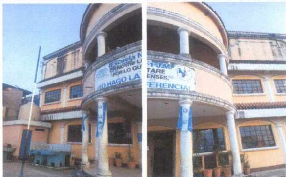
Foto 1: En las fotografías se puede observar el mal estado en el que se encuentra la pintura de la escuela, por eso se pintará.
