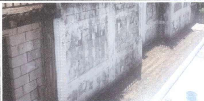
Foto 2: El muro perimetral debe de estar garantizado, para evitar accidentes de la comunidad educativa.
