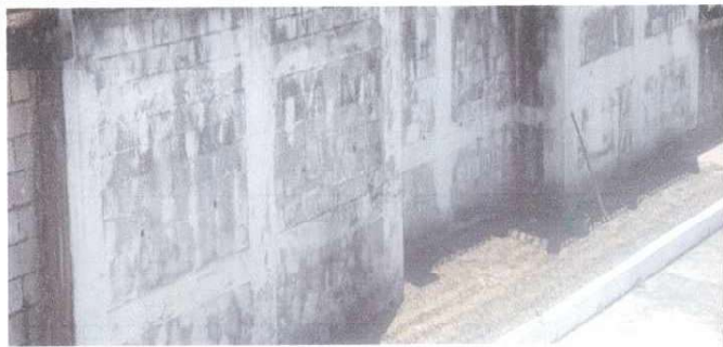
Foto 1: El muro perimetral del establecimiento, esta deteriorado, por lo que necesita la sustitución para la seguridad de los niños.
