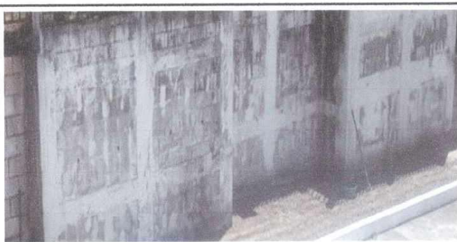
Foto 3: El muro perimetral del establecimiento, debe estar bien asegurado, cumpliendo las normas y especificaciones necesarias.
