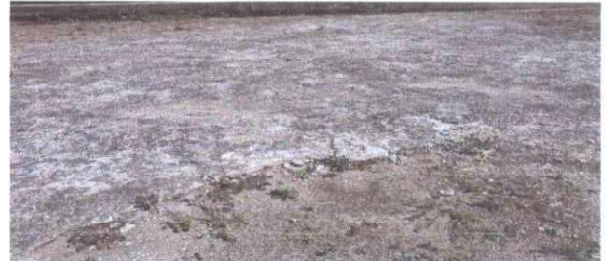
Foto 2. Se Reemplazará el piso de concreto por deterioro
