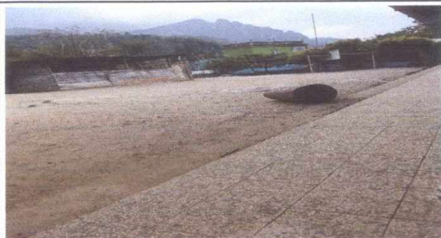
Foto1: Losa de patio en mal estado.
