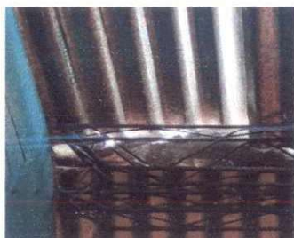
FOTO 3: LAMINAS DETERIORADOS, EN MAL ESTADO.
