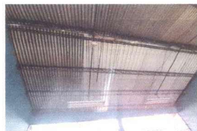
FOTO 2; SUSTICION DE LAMINAS.
