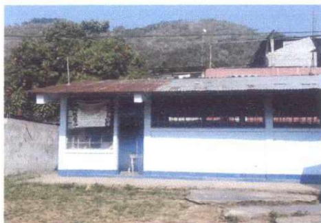
FOTO 1: LAMINAS EN MAL ESTADO DEL CENTRO EDUCATIVO.
