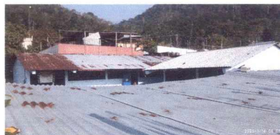
FOTO 4; TECHO ESCOLAR DETERIORADO.
