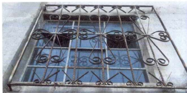
Foto 2: Ventanas y Balcones en mal estado
