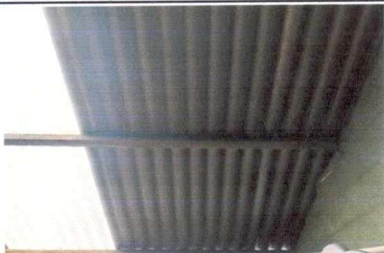
Foto1: Techo y Pared en mal estado
