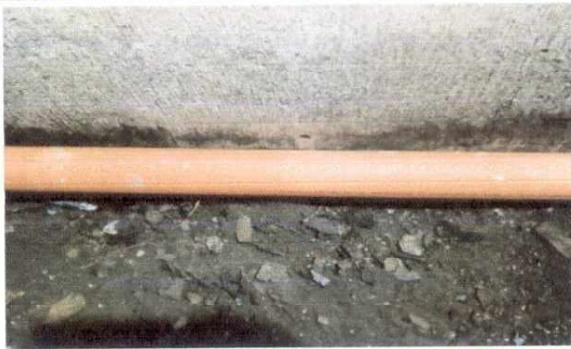
Foto 9: Red de drenaje en mal estado
