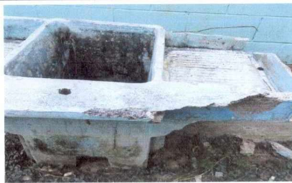
Foto 4: Pila en mal estado
