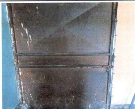
Foto 3: Puertas en mal estado
