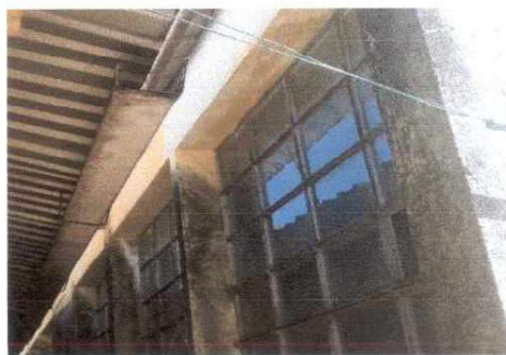
FOTO 4: Canales pluviales en mal estado
