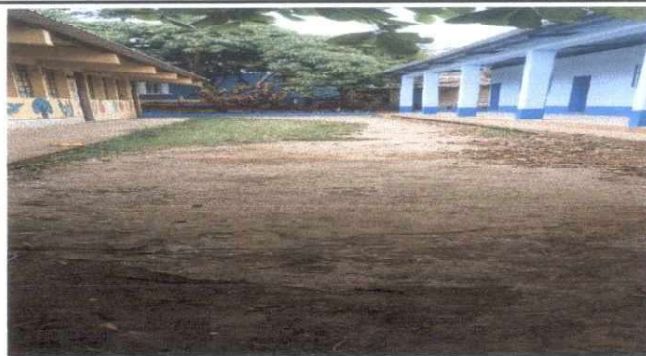
FOTO 2: Losa de patio en mal estado
