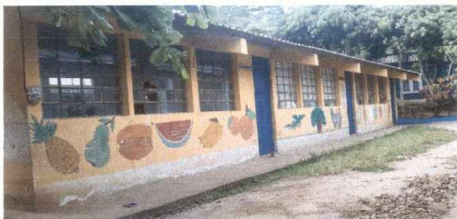
FOTO 3: Vidrios de las aulas quebradas
