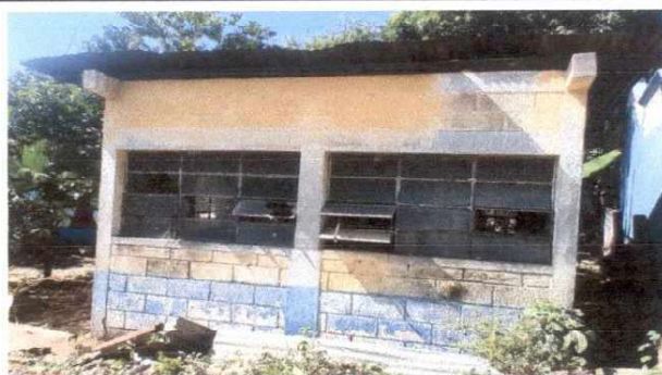
FOTO 6: Pintura en muros exteriores e interiores de cocina
