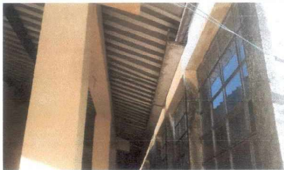
FOTO 1: Lamina deteriorado del corredor
