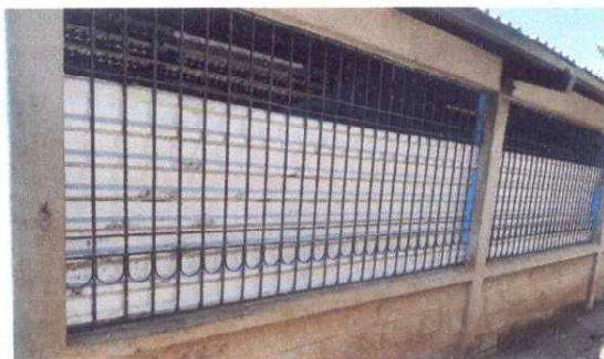
Foto 3: VENTANAS EN MAL ESTADO
