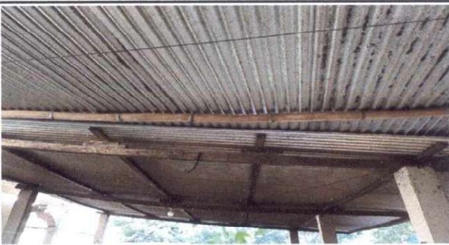
Foto 3: Cubierta de lámina (estructura de madera deteriorado)
