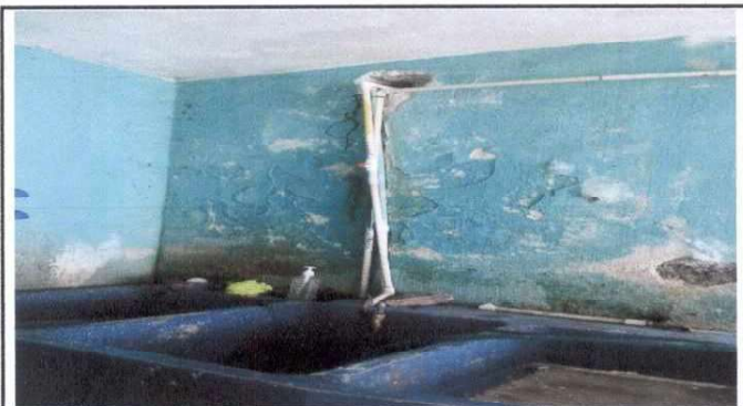
Foto 3: Lavamanos a en mal estado
