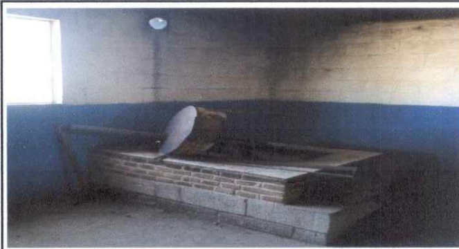
Foto 2: Cocina en mal estado a reparar.
