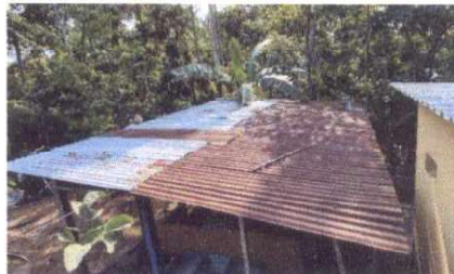
FOTO 2: AREA DE LAMINAS EN MAL ESTADO.
