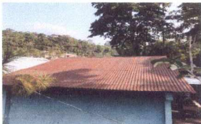
FOTO 1: SUSTICION DE LAMINAS EN MAL ESTADO.
