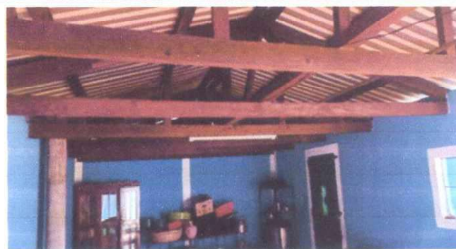
Foto 4: Cocina Necesita machimbrado
