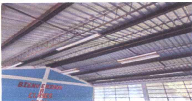
Foto1: Aula necesita machimbrado.
