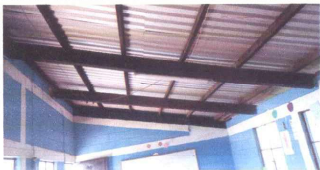
Foto 3: Aula necesita machimbre.
