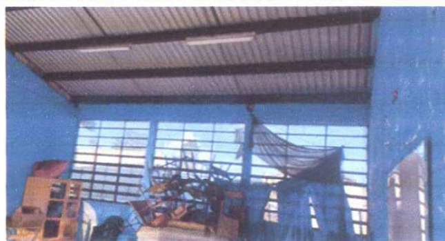
Foto 2: Aula necesita machimbre.
