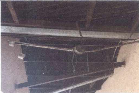
Foto 3: Sistema Electrico en mal estado
