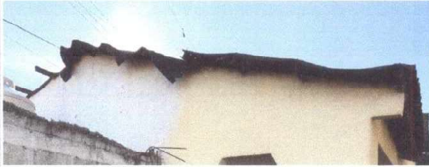
Foto 1: Cubiertas de lamina deteriorada
