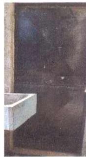
Foto 6: Mantenimiento de puerta deteriorada
