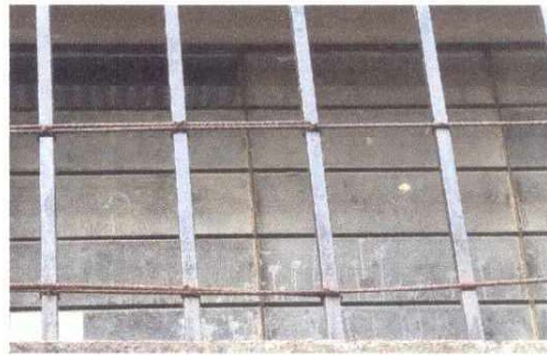
Foto 2: Balcones en mal estado
