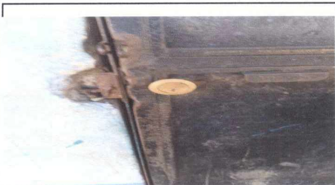
Foto 3: Puerta oxidada sin chapa.
