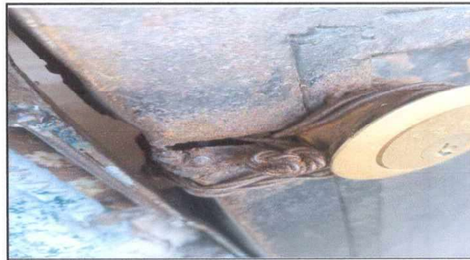
Foto 4: Puerta en mal estado.
