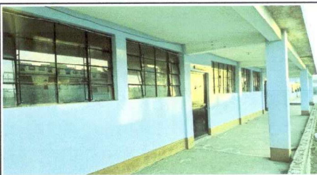
Foto 6: Barandas en mal estado
