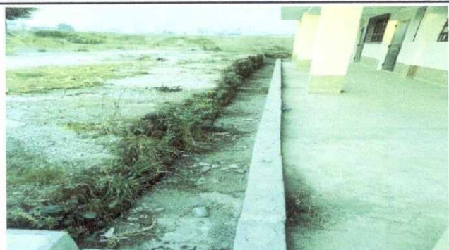
Foto 1: Muro perimetral en mal estado
