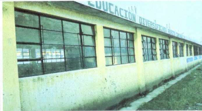
Foto 4: Pintura en mal estado
