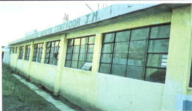
Foto 3: Pintura en mal estado
