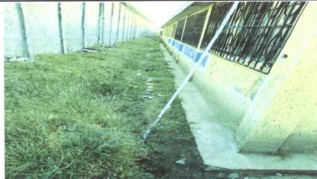
Foto 2: Cunetas en mal estado
