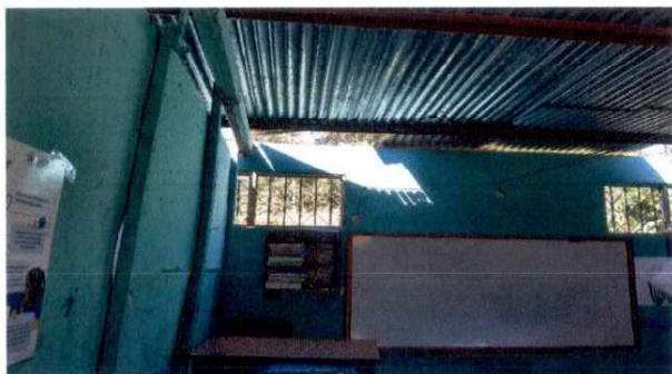
FOTO 1. CUBIERTA DE LAMINA EN MAL ESTADO.
