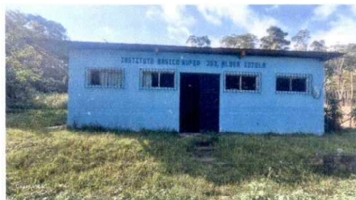
FOTO.2 PUERTAS EN MALAS CONDICIONES.
