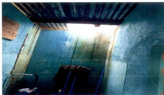
FOTO. 4 SERVICIOS SANITARIAS EN MALAS CONDICIONES
