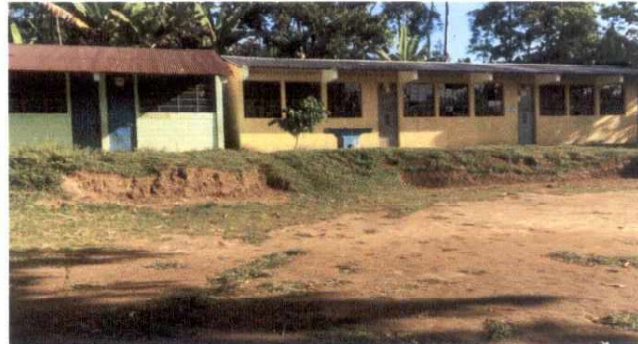
FOTO. 2 LOSA DE PATIO EN MALAS CONDICIONES
