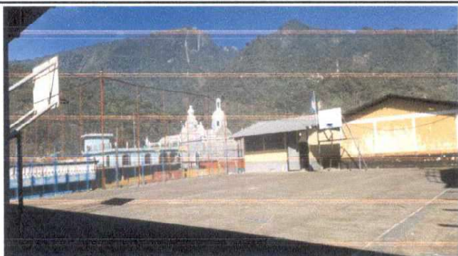
Foto1: El techo de la escuela se encuentra en condiciones inadecuadas para la comunidad educativa
