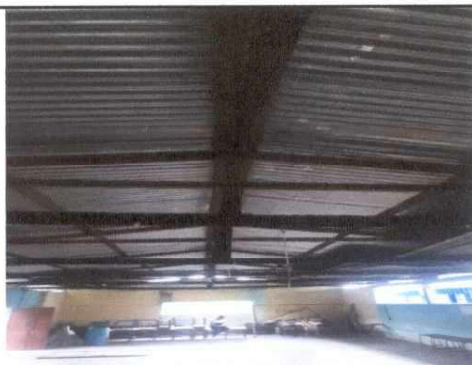
Foto 3. Madera del salón de aula en mal estado.
