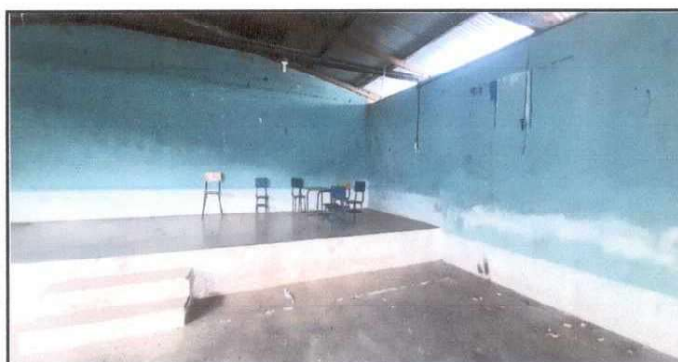
Foto 5. Pintura del salón de aula deteriorado en mal estado
