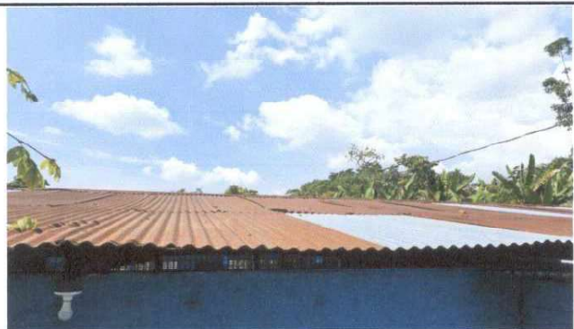
Foto 1. Lámina del Salón de Aula deteriorado.
