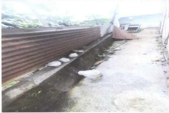
Foto 7. Muro perimetrales en mal estado
