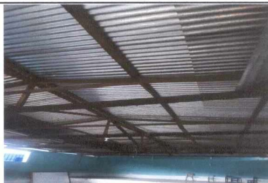
Foto 4. Madera del salón de aula en mal estado.
