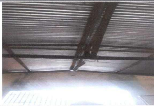
Foto 2. Lámina del Salón de aula deteriorado.
