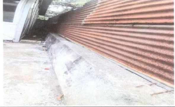
Foto 8. Muro perimetrales en mal estado.
