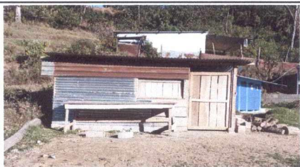
Foto 1: REPARACIÓN O SUSTITUCIÓN DE ÁREA DE COCINA (Cimiento de block deteriorada)
