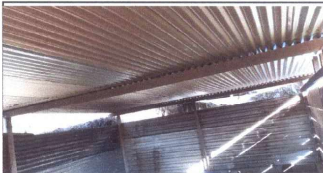
Foto 4: REPARACIÓN O SUSTITUCIÓN DE ÁREA DE COCINA (Estructura de techo de madera deteriorada y sin sistema eléctrico)
