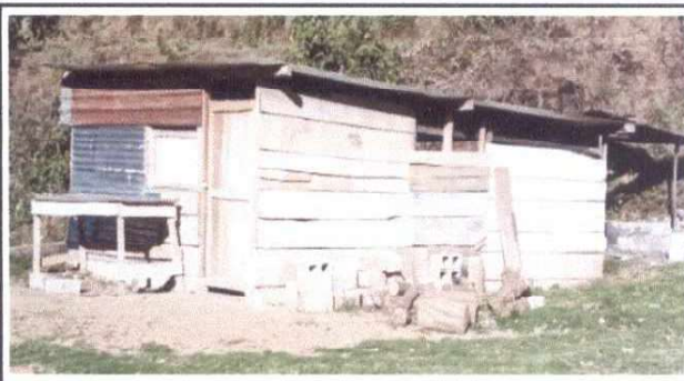
Foto 2: REPARACIÓN O SUSTITUCIÓN DE ÁREA DE COCINA (Paredes de láminas y madera deteriorada)
