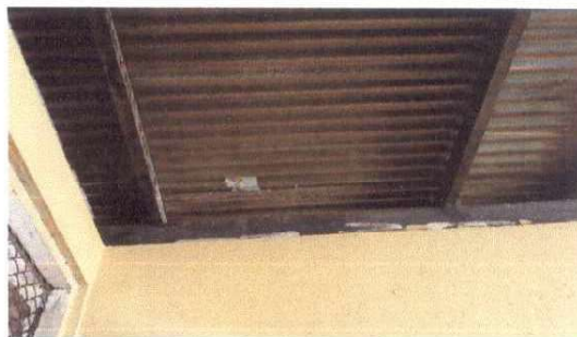
FOTO 2: LAMINAS DETERIORADAS DEL MODULO DE AULAS
