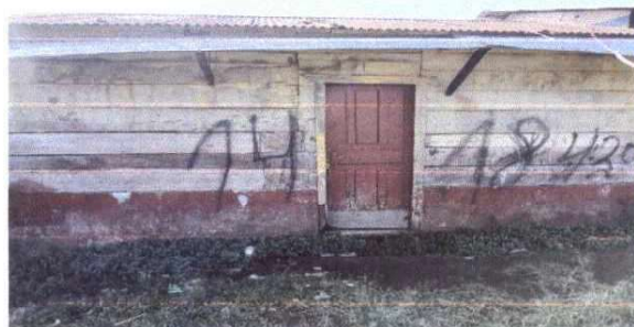
FOTO 4: CUBIERTA DE LAMINAS, ESTRUCTURA DE TECHO, PAREDES DE MURO INTERIOR Y EXTERIOR DETERIORADAS.
