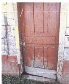
FOTO 3: PUERTA DE AULA EN MAL ESTADO
