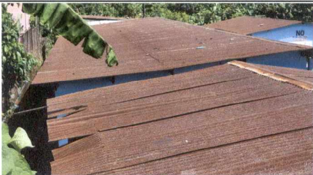
Foto 1: Cubierta de lámina (Láminas deteriorada)
