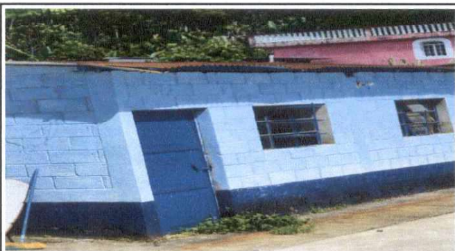
Foto 3: Cubierta de lámina (Techo deteriorado)
