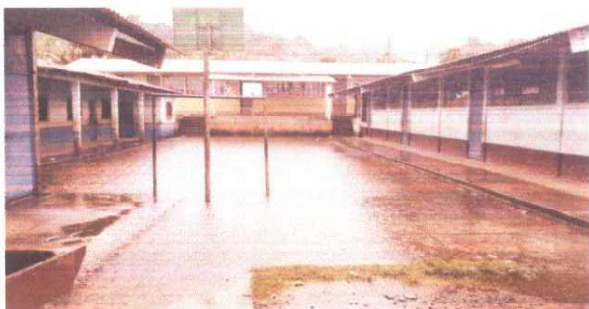
FOTO 1: LAMINA EN MAL ESTADO
