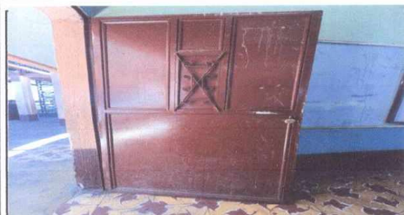
Foto 5: Estado de la puerta exterior en mal estado.
