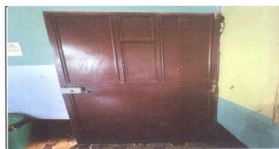
Foto 6: Estado de la puerta interior en mal estado.
