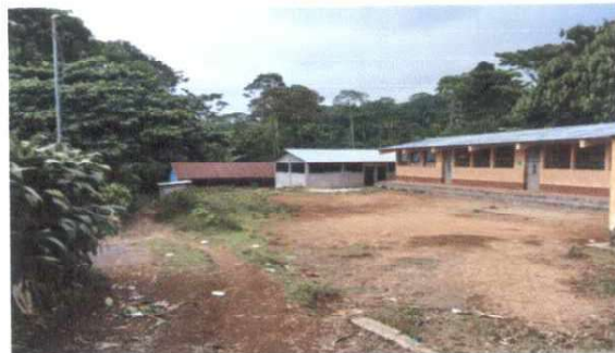
FOTO.2 LOSA DE PATIO EN MALAS CONDICIONES
