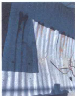
Foto1: cubierta de lámina, sustitución de láminas por oxido
