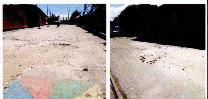
Foto 6: Patios de la escuela en malas condiciones
