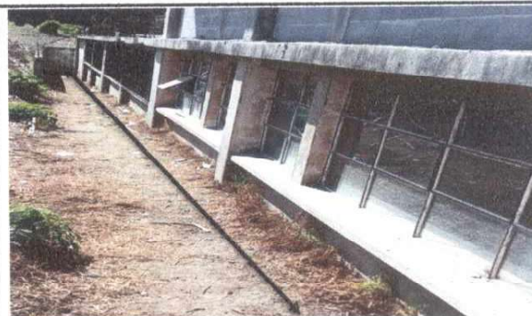
Foto 4: LOSA DE PATIO POR FILTRACION DE AGUA, ATRÁS DE LAS AULAS
