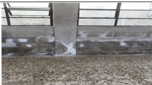
Foto 11: Se necesita pintar Modulo Ay B incluye cocina.( interior y exterior).
