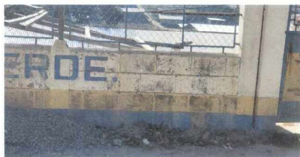
Foto 10: Se necesita pintar toda la circulacion de la escuela .
