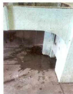
Foto 4: Se necesita pintar la pila, remodelar en el interior con azulejo y un espacio en la pared para que el agua no moje la pared. Tambien se hara un trabajo de limpieza y reparacion de drenaje general.
