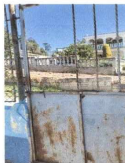
foto 2. se necesita cambio de puerta en mal estado entrada No2
