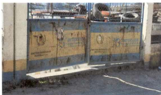
Foto 6: Se necesita cambio de porton del ingreso principal,
