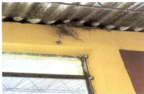
Foto1: cubierta de lamina, se muestra el espacio que necesita sellar para evitar la entrada de pajaros.
