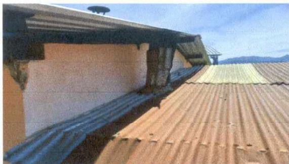
FOTO 1 Cubierta de lámina: Sustrucción cubierta de lámina, quebradas y oxidadas.
