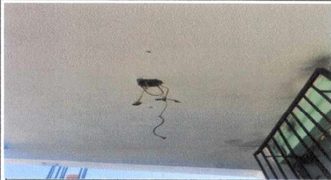
Foto 1: SISTEMA ELÉCTRICO GENERAL EN MAL ESTADO
