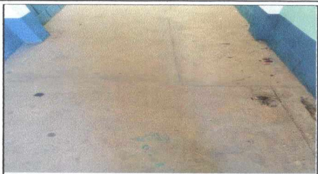
Foto 2: PATIO DEL NIVEL PARVULOS EN MUY MAL ESTADO
