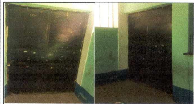
Foto 3: PUERTAS EN MAL ESTADO.
