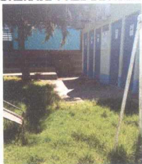
Foto 3: Red de drenaje y sistema de agua en mal estado
