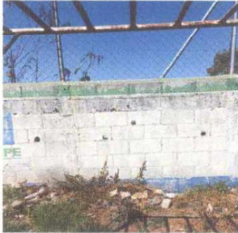
Foto 1: Muro de contención en mal estado
