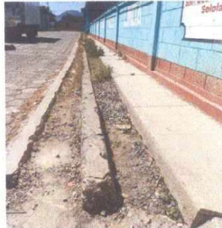
Foto 2: Cuneta en mal estado
