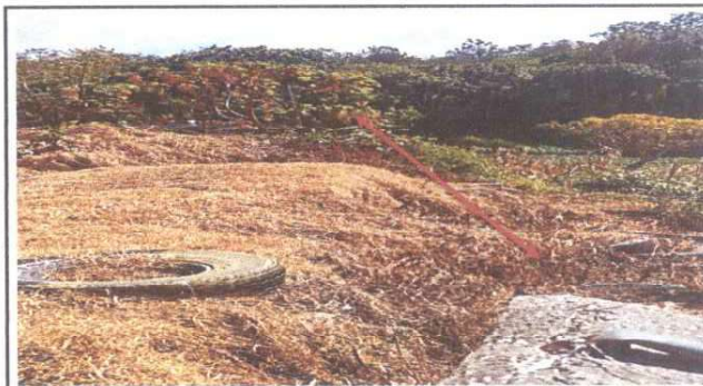
Foto 4: En esta parte es muy peligroso para los niños pequeños se podría caerse por falta una parte del muro.
