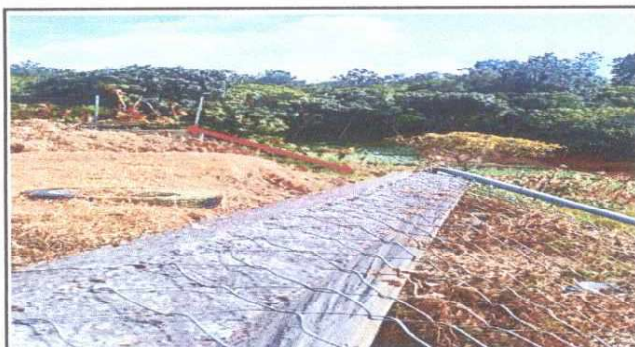
Foto 3: Lado oriente horizontal se necesita complementar el muro perimetral con una medida de 16 mt de largo X 3mt. con 50 cm. de altura.
