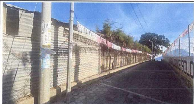
Foto 1: Vista Panorámica del Muro Perimetral de Malla lado Oeste de la Escuela que necesita sustituirse para una mejor seguridad escolar.
