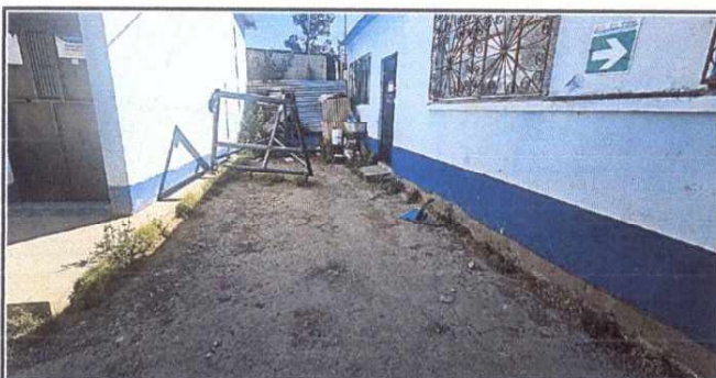
Foto 5: Vista de área en mal estado que necesita Losa de Patio, para mejorar la infraestructura de la escuela.
