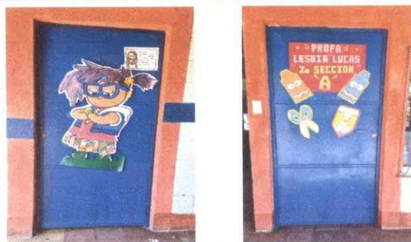
Foto 6: Puertas de aulas que deberán de ser cortadas, lijadas y de nuevo pintadas.
