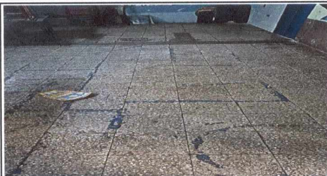
Foto 1: Piso en mal estado, deteriorado y picado
