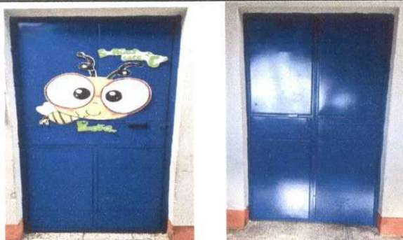
Foto 5: Puertas de aulas que deberán de ser cortadas, lijadas y de nuevo pintadas.
