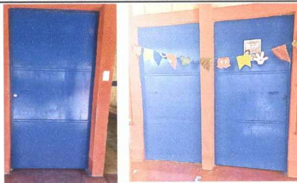
Foto 4: Puertas de aulas que deberán de ser cortadas, lijadas y de nuevo pintadas.
