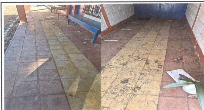
Foto3: Pisos del pasillo del lado izquierdo se encuentran deteriorados y en mal estado.
