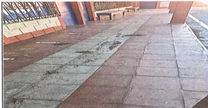
foto 2: Pisos del pasillo del lado derecho se encuentran en mal estado
