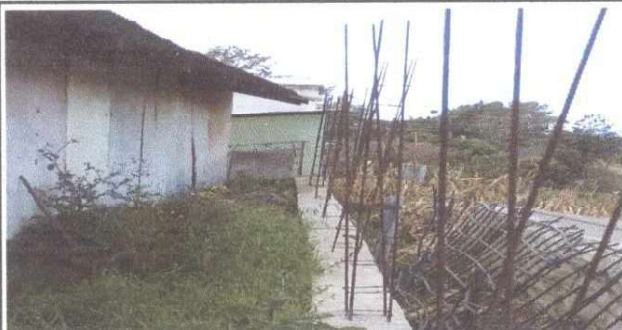
Foto 3: Muro Perimetral no terminado
