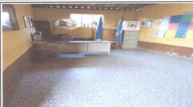
Foto 2: Pintura del Establecimiento interior deteriorado
