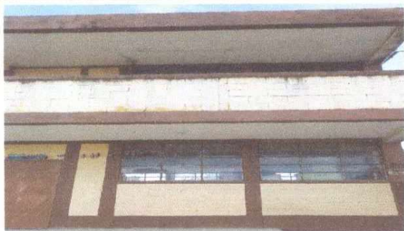
Foto1: Pintura del Establecimiento exterior deteriorado
