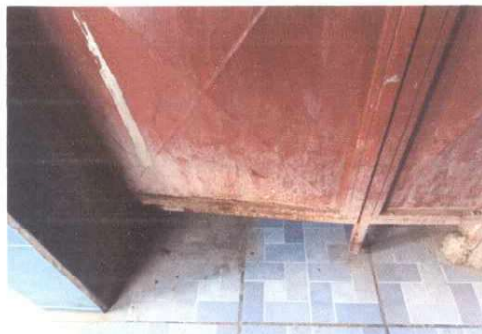
Foto 3: Cambio de puertas porque ya se encuentra en mal estado.
