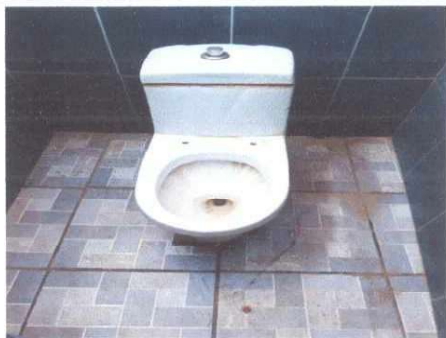
Foto1: En mal estado el servicio sanitarios
