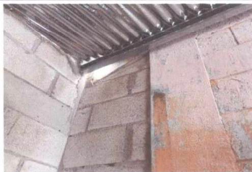
Foto 4. Cambio de lamina porque cae agua en la cocina
